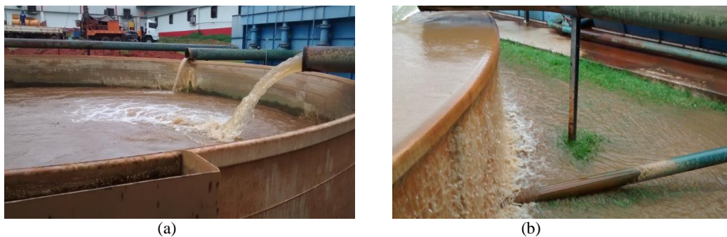
Figura 1. (a) Detalhe da atividade de lavagem de filtros e (b) Detalhe do transbordamento do tanque de recuperação das ETAs, indústria alimentícia 2015.
